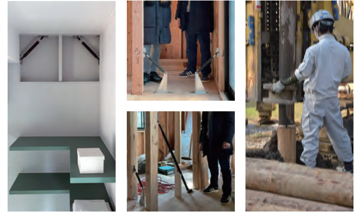
ダンパー：書斎隔断部から免震の長さを確認できる。 各所に設置されたダンパー 木材：防菌処理した3m長のカラマツ材を打ち込む。
